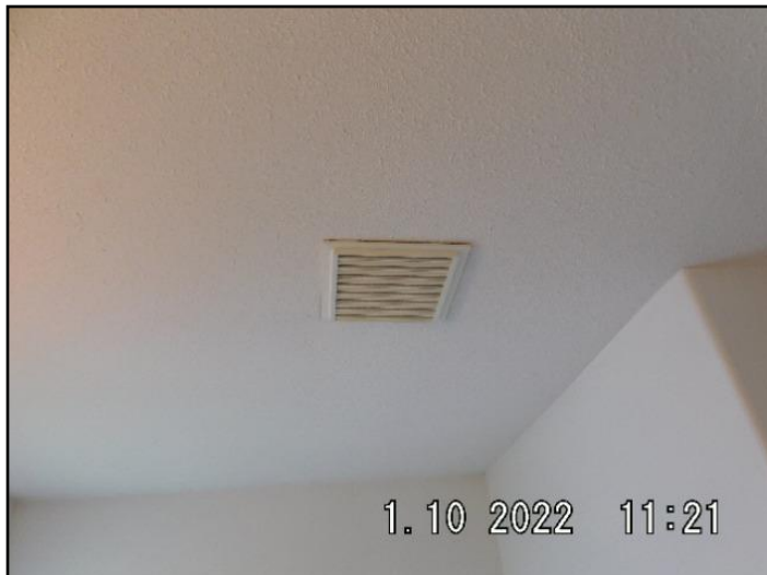
106. Exhaust fan bathroom 2
